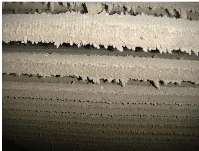
Vorüberhitzer 2 (VUE 2) bei Reinigung mittels Russbläsern
