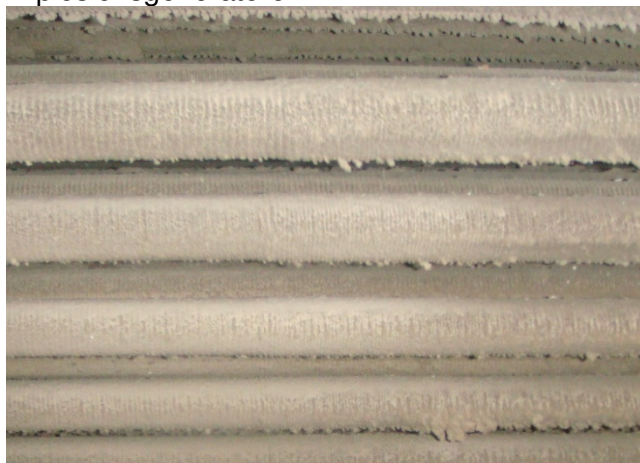
Vorüberhitzer 2 (VUE 2) bei Reinigung mittels Explosionsgeneratoren
