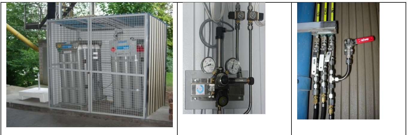
Abbildung 5: Komponenten der Gasversorgung: Kleinbündel; Druckreduzierarmatur; Absperrung beim einzelnen Generator
