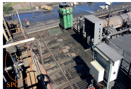
Abb. 12: Gesamtansicht SPG am HRSG Steuerschrank, Gasflaschenbündel
