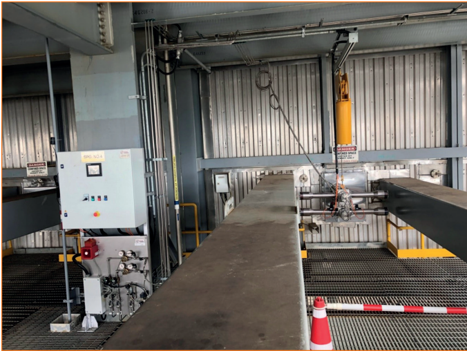
Abb. 14: Gesamtansicht mit SPG TwinL aussen am Kes- sel, Schaltschrank und Ventilpanel
