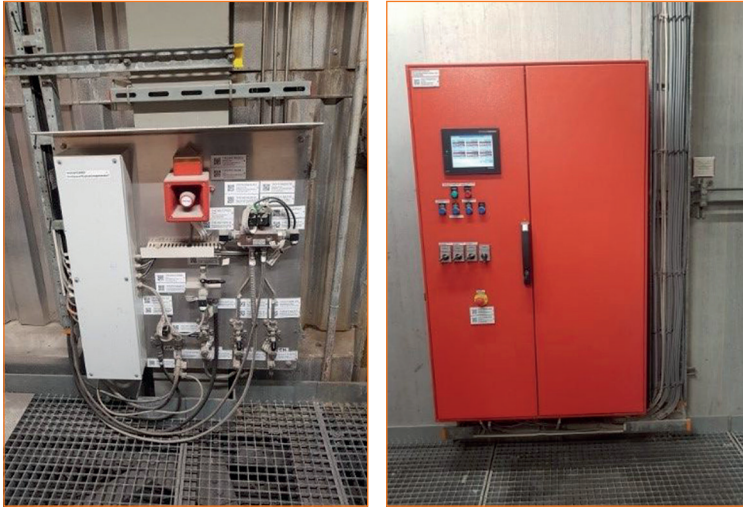
Abb. 7: Ventilpanel je SPG (links) und Steuerschrack EG104 für jeweils 3 SPGs einer Kessellinie
