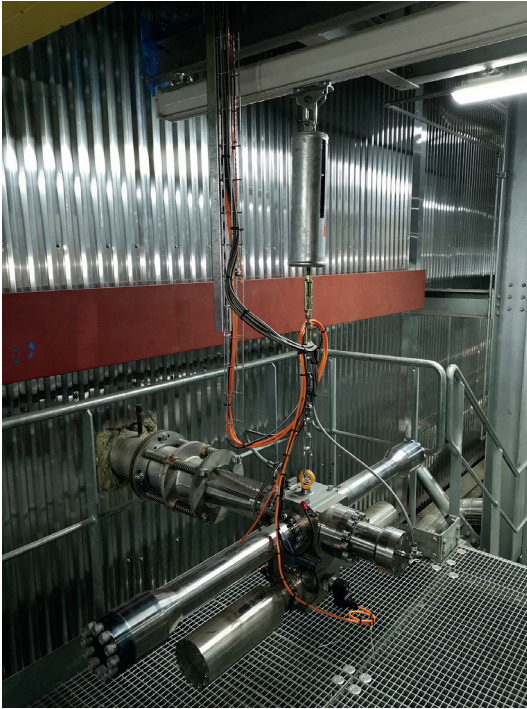
Abb. 4: Horizontal eingebauter Shock Pulse Generator
