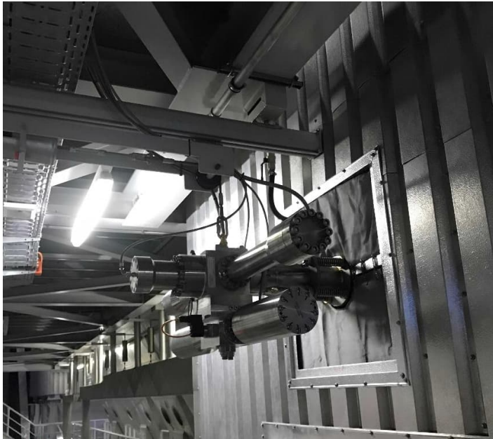
Abb. 4: Shock Pulse Generator EG10L im dritten Zug der KVA Bern Forsthaus (Foto Explosion Power GmbH)
