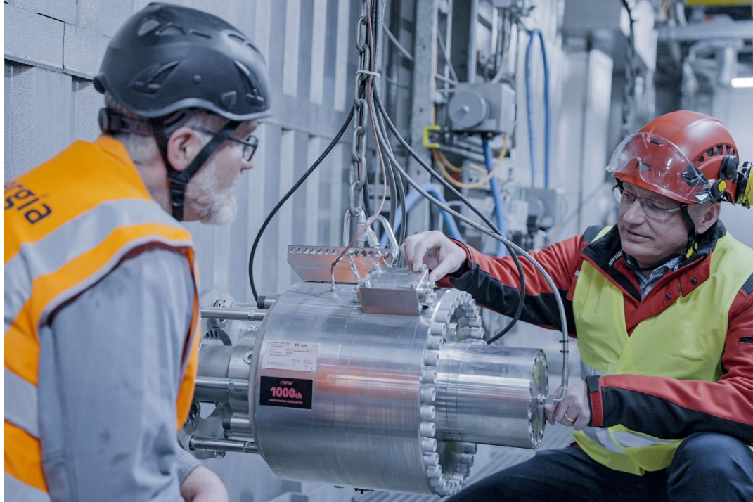
Abb. 5: Feierliche Inbetriebsetzung des 1000. SPG (Foto: Explosion Power GmbH)
